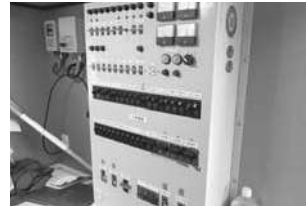
船内電源配電盤
