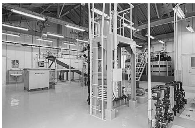
浸出水処理施設内部
