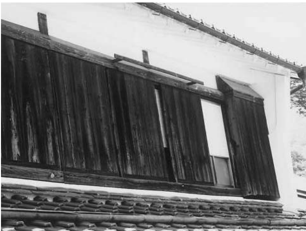
写真⑧ 軒裏を漆喰で塗り込め、隣家との間に防火壁を設けた家
